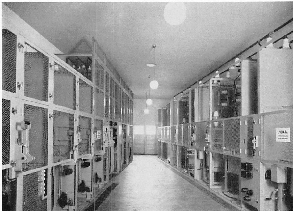
Omformarstation av typ III, 6 och 16 kV-stativ.
