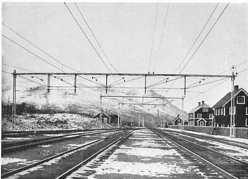
Ledningsbrygga av den äldsta vid malmbanan förekommande typen, den s. k. "Kirunatypen". Bärlinan isolerades genom två på ömse sidor om det övre utliggarröret i bärlinan insatta isolatorer, under det att det undre utliggarröret isolerades vid upphängningspunkten intill bryggvertikalen.
