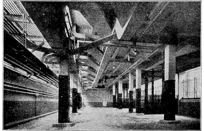
Abb. 9. Führung der Leitungen im Gepäckräume.
