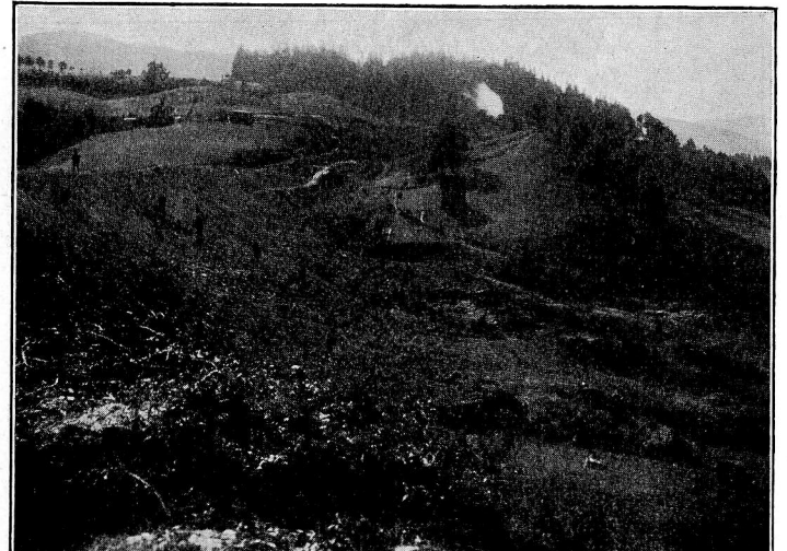
Abb. 15. Zweite Dammrutschung am Gaissacher Hang (Damm I).
