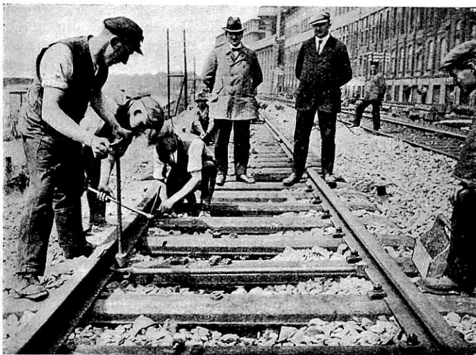
Abb. 14. Spreizen der Schienen in ihre richtige Lage und Anbringen der inneren Befestigung.
