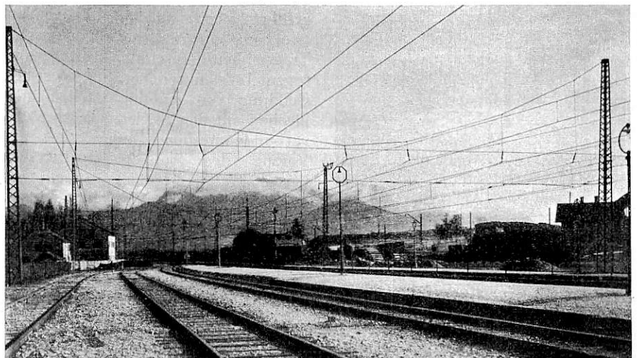
Abb. 26. Querseilaufhängung mit unter Spannung stehendem Richtseil und Stabisolatoren.
