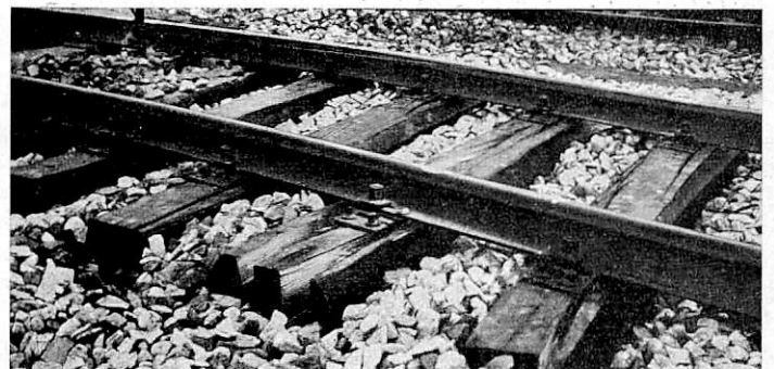
Abb. 27. Beim Ausknicken des Gleises des Oberbaues K auf Holzschwellen mit 30 m Schienen gerissene Schwellen.
