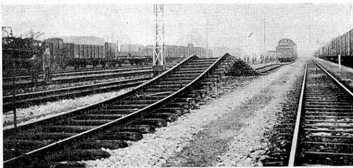
Abb. 21. Ausgeknicktes Gleis des Oberbaues K auf Eisenschwellen mit 15 m Schienen.
