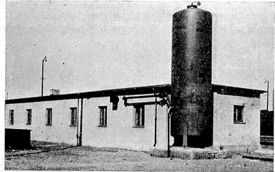
Abb. 9. Verdichterhaus mit Luftkessel.
