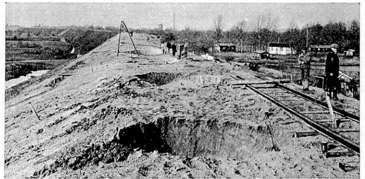
Abb. 15. Durch Tiefensprengung entstandener Sprengtrichter.
