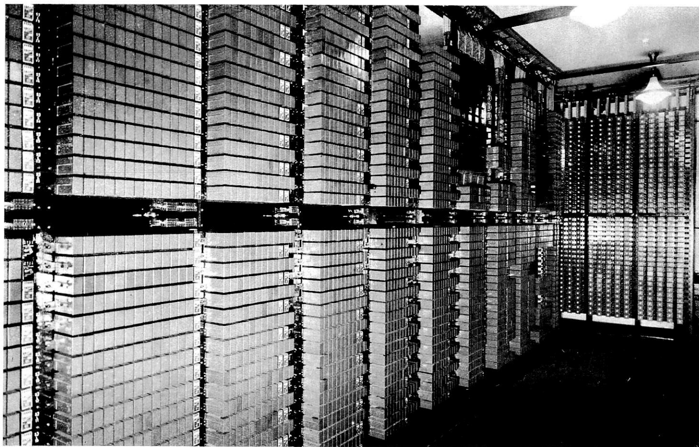
Fig. 33. Interiör från automatväxeln visande linjerelästativ och relärad. Bilden av år 1945.
