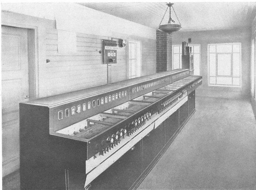
Bild 5. Ställverk II, Eslöv.
